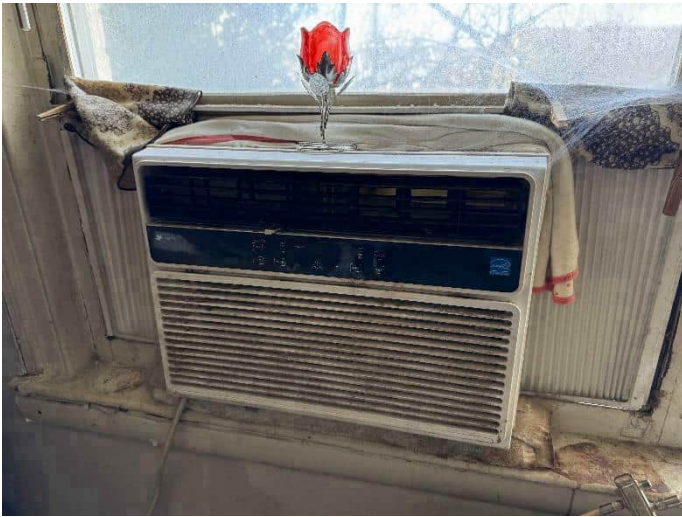
68. Window AC unit.
